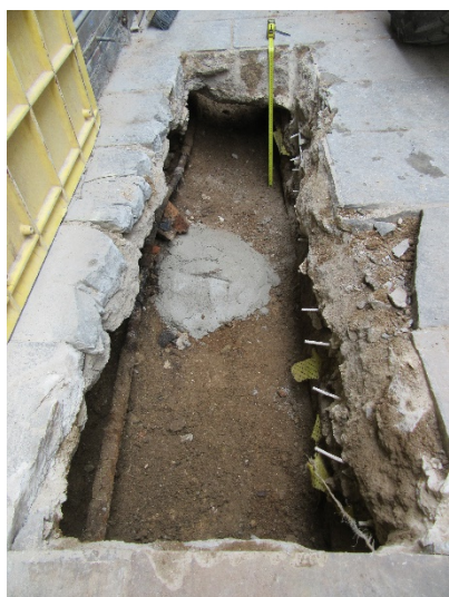
Foto 5. Final tram de la Rasa 1, a la finca núm. 23. Vista des del sud.
